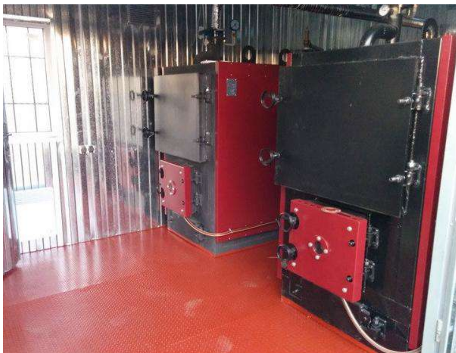
Малюнок 63. Твердопаливна модульна котельня
